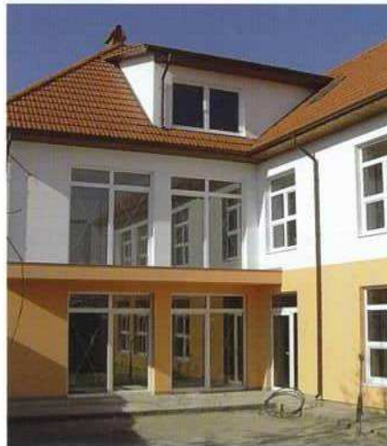
Im Bau: Tagesstätte für Kinder und Jugendliche mit geistiger Behinderung in Stauceni
